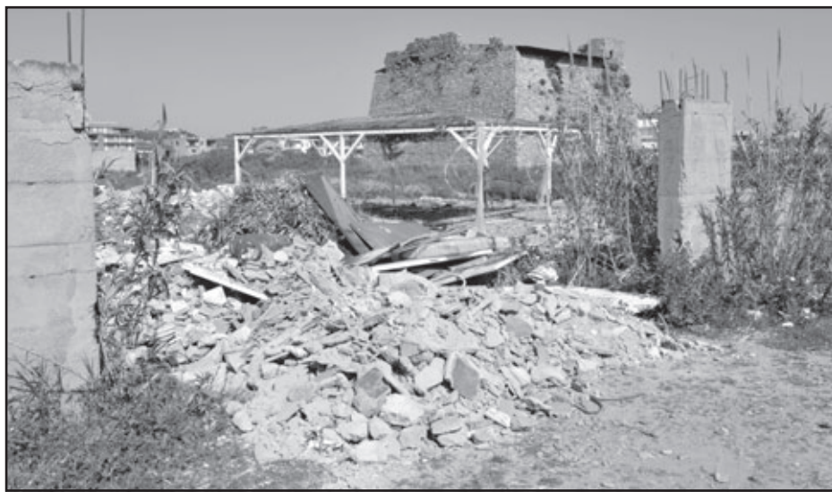
TORRENOVA FA DA "SFONDO" ALLE CATASTRE DI RIFIUTI EDILI ABBANDONATI POCO DISTANTE
