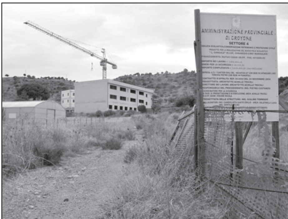
Il cantiere, ormai abbandonato da tempo, del polo scolastico di località Ceramidio che ospiterà le classi dell'Istituto di studi superiore 'Giuseppe Gangale'; in basso, il dirigente scolastico Rocco Bono
