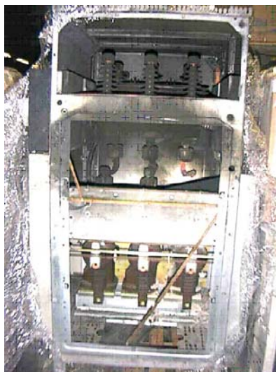
Figura 17 – Vista frontale del quadro a seguito dell'incidente.
