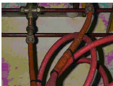
Figura 10 – Problema nell'intestazione del cavo.
