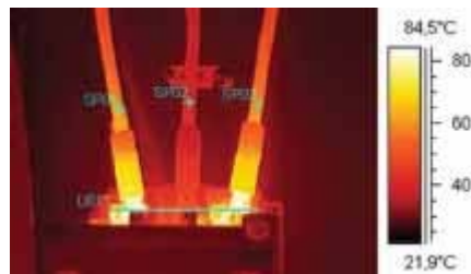
Su due delle tre fasi uscenti da un interruttore BT è evidente un sovraccarico.
