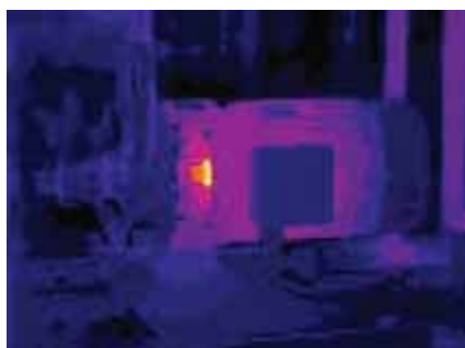
Il cuscinetto anteriore del motore collegato ad una pompa raggiunge la temperatura di 81°C.
