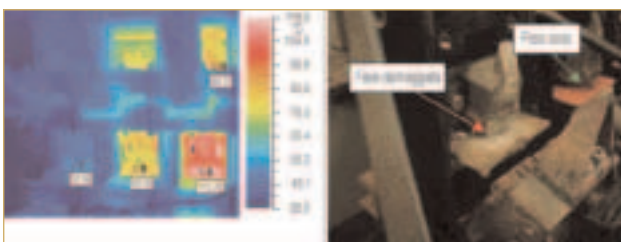
In questa sequenza si vuole mettere in evidenza, che con una corretta indagine termografica si possono evitare notevoli danni alle apparecchiature elettriche prima che si verificano danni notevoli. L'interruttore rappresentato nella foto visibile ha subito un principio di incendio dovuto all'eccessivo surriscaldamento dei contatti.
