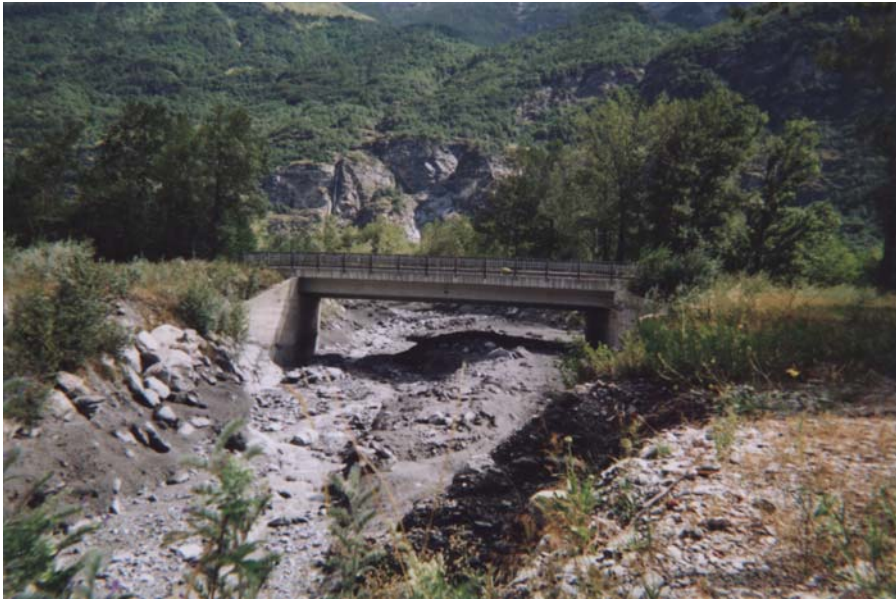
Fig. 8.29. T. Marderello – Il ponte della strada provinciale Susa – Venaus – Novalesa ha rischiato di essere completamente occluso dai sedimenti (Foto realizzata il 6 Agosto 2005).
