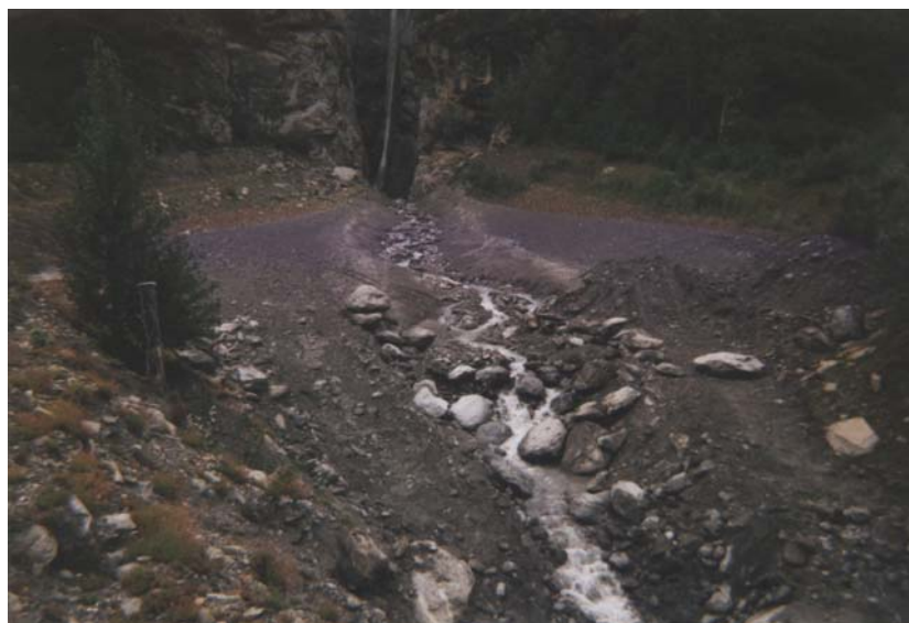
Fig. 8.28. T. Marderello – La vasca di deposito a valle del “Salto di Novalesa” risulta completamente colmata (Foto realizzata il 6 Agosto 2005).
