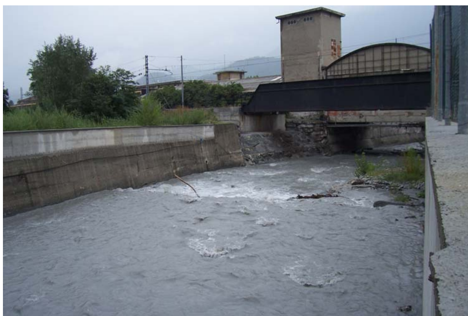
Fig. 6.31. Torrente Cenischia – Sezione in corrispondenza del ponte ferroviario, di recente ricostruzione, dopo i danni causati dalla piena dell'Ottobre 2000. Sullo sfondo, il fabbricato che non consente il transito della portata cinquecentenaria.
