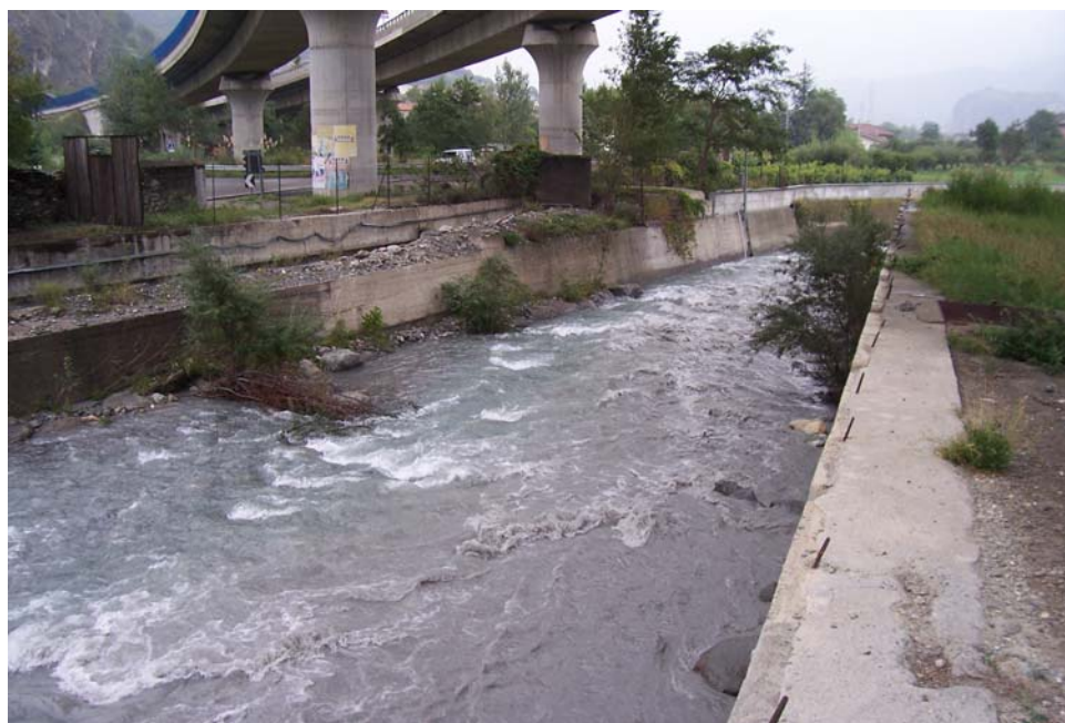
Fig. 6.34. Torrente Cenischia – Sotto il viadotto autostradale è posta la sezione nella quale si presume sia avvenuta l’esonazione dell’Ottobre 2000. In tale posizione era presente un attraversamento provvisorio in lastre di calcestruzzo armato che può avere contribuito alla diminuzione della sezione utile dell’alveo.
