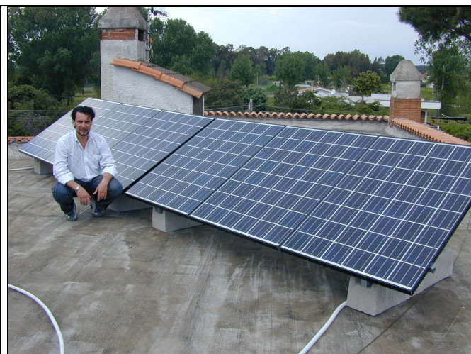
Impianto da 2,1 kW di picco nel Comune di San Felice Circeo (LT) giugno 2008
