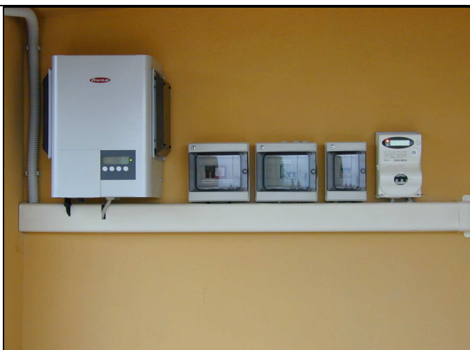
Inverter, quadri di campo e Misuratore delle produzioni
