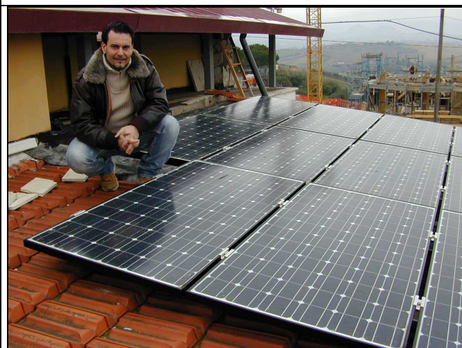
Impianto da 2,94 kW di picco nel Comune di Fonte Nuova (RM) gennaio 2009
