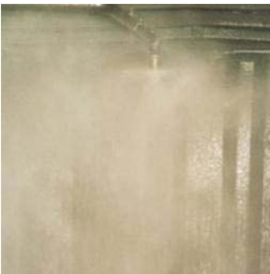
Fig. 11 Impianto Sprinkler in funzione.
