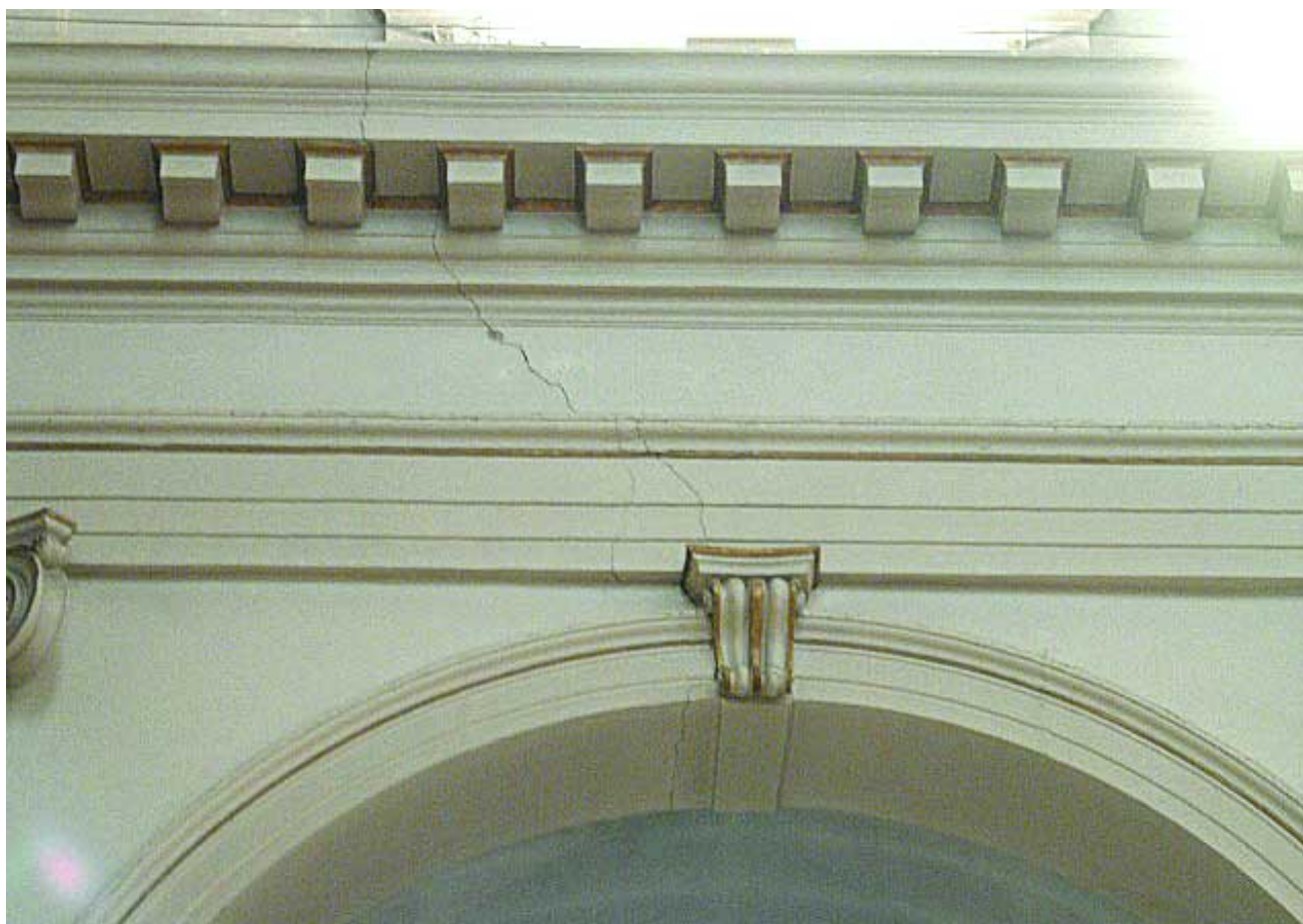
Arco costituito da muratura stratificata che tende a scollegarsi sotto carico, con rischio di crollo locale.
