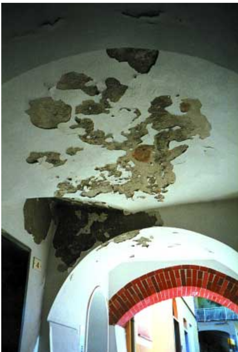
Distacco di porzioni d'intonaco a causa di infiltrazioni d'acqua.
