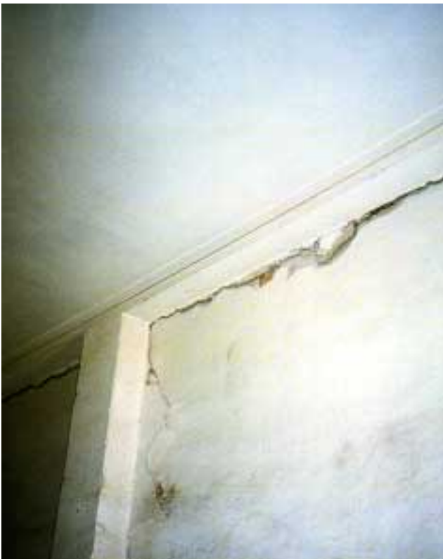
Distacco tra una struttura portante di cemento armato (travi e pilastri) accostata a un tamponamento in laterizio, causato dalla rotazione fondale della nuova struttura rispetto a quella preesistente.
