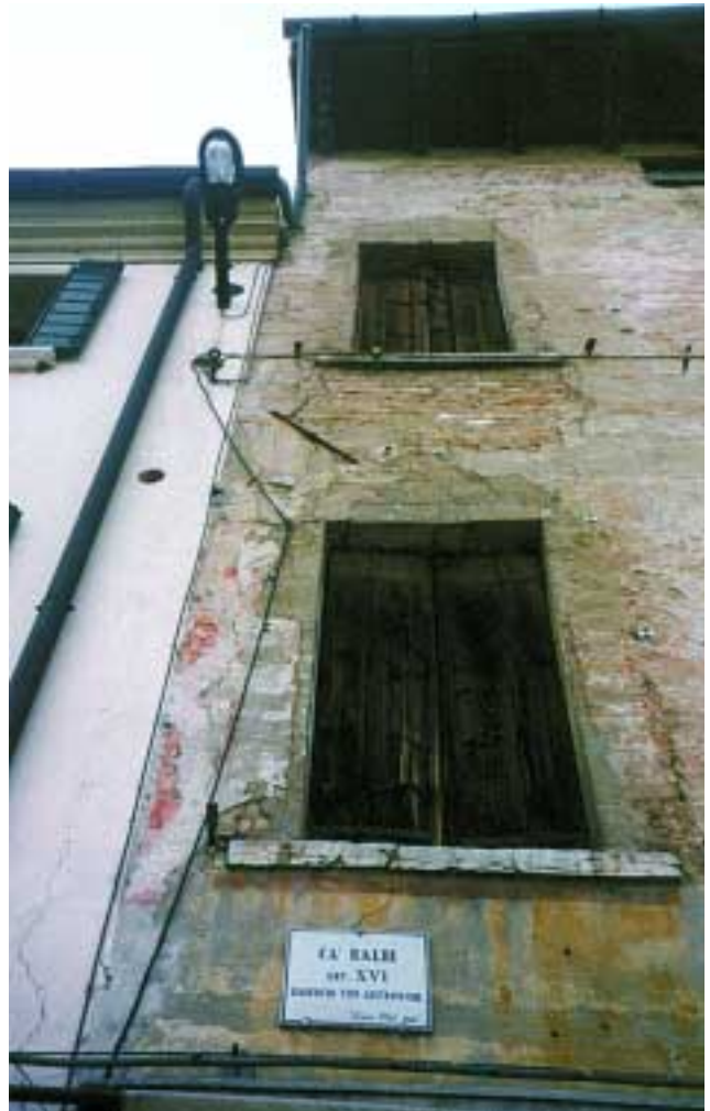
Lesione di architrave monolitico in pietra di una finestra e della muratura soprastante. L'architrave si è scomposto in più "conci" formando di fatto un arco estremamente ribassato e quindi una spinta laterale sulla muratura circostante. Il fenomeno è legato alla realizzazione dell'edificio laterale che ha causato cedimento del terreno.
