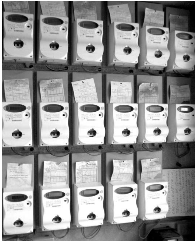
I contatori dell'elettricità [foto Calvaresi]
