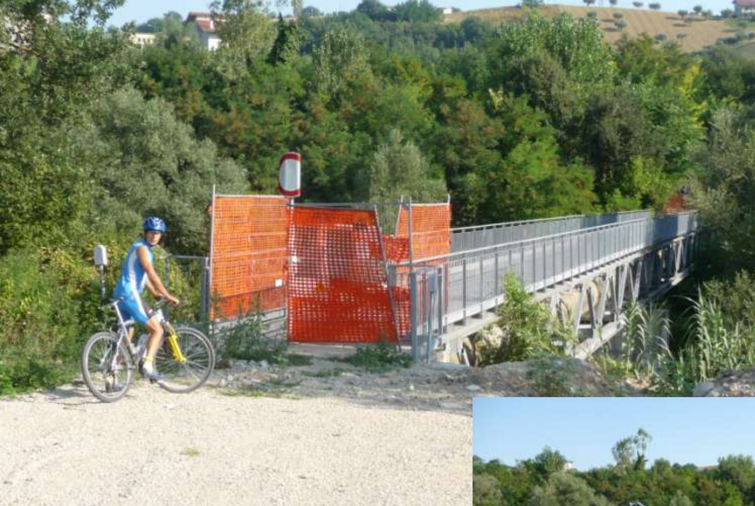
la passerella sulla condotta idrica
