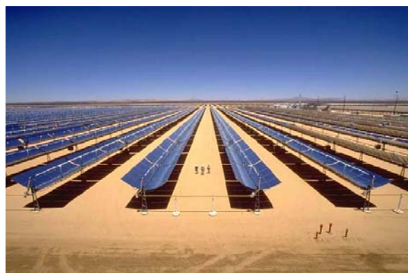
Fig. 6 - Vista di parte di un impianto SEGS a Kramer Junction (fonte: [19])
