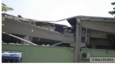
Perdita di appoggio della trave e collasso della copertura
