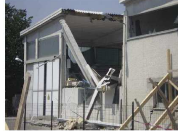
Perdita di appoggio della trave per rottura della connessione
