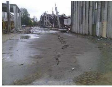
Rotazione pilastro dovuta alla formazione di cerniera plastica alla base
