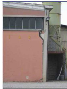
Cerniera plastica alla base del pilastro
