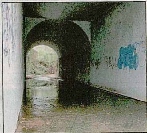
Il sottopasso della stazione delle Ferrovie a Santa Palomba che si allaga ad ogni precipitazione
