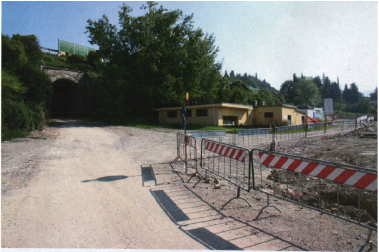
Foto n. 4 – impianto di sollevamento acquedotto
