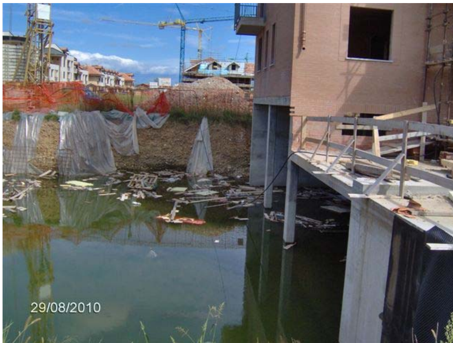
FOTO 1 - Cantiere di palazzina in costruzione in via Montegrappa, scattata 15 giorni dopo le piogge del 13/14-8-2010. L'acqua aveva raggiunto un livello più alto riempiendo lo scavo. Quindici giorni dopo l'acqua non è ancora stata riassorbita dal terreno.
